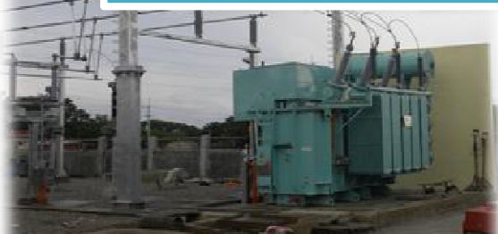
Development of Tagaytay West Substation
